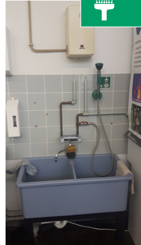
Waschbecken mit Augendusche
